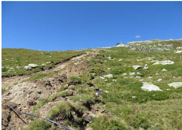
Leitung für die Beschneigungsanlagen Unterstafel – Gütsch (25.08.2016)
