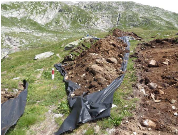
Wasserleitung vom Lutersee gegen den Schneehüenerstock
