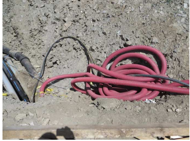
Kabel für Frisch- und Abwasser, Beschneigungs- anlagen und Strom
