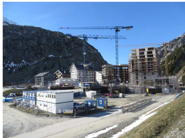
Die Gotthard Residences in Kombination mit dem Radisson Blu Hotel im Bau (05.05.2017)
