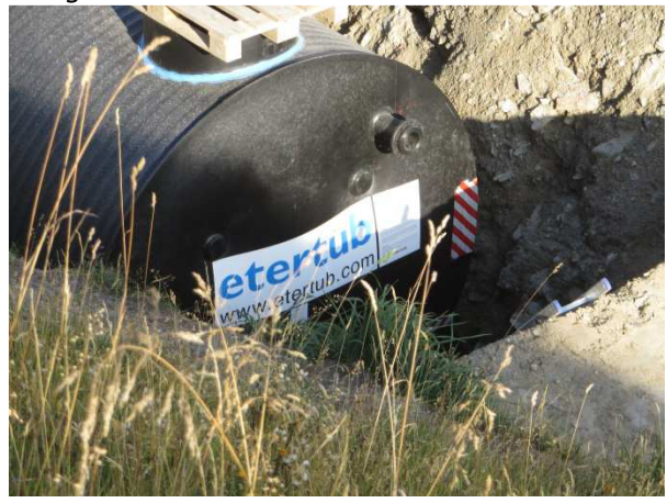
Aufbereitung von Trinkwasser oberhalb Nättschen
