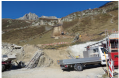
Wasserleitung ab der Pumpstation Oberalp in Richtung Vorder Felli – Schneehüenerstock.
