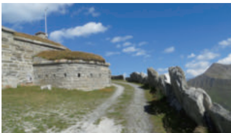
Die Anlagen des Fort Stöckli auf dem Gütsch sind baufällig.
