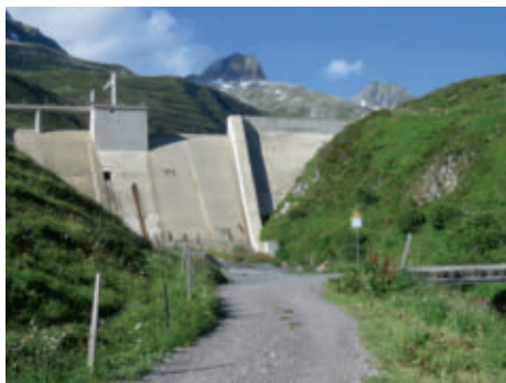
Mit der Stauanlage in der „Schöni“ kann die Wassermenge reguliert werden.
